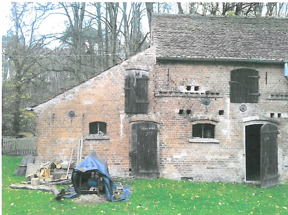
Fragment elewacji zachodniej – widoczne spękania ścian.
