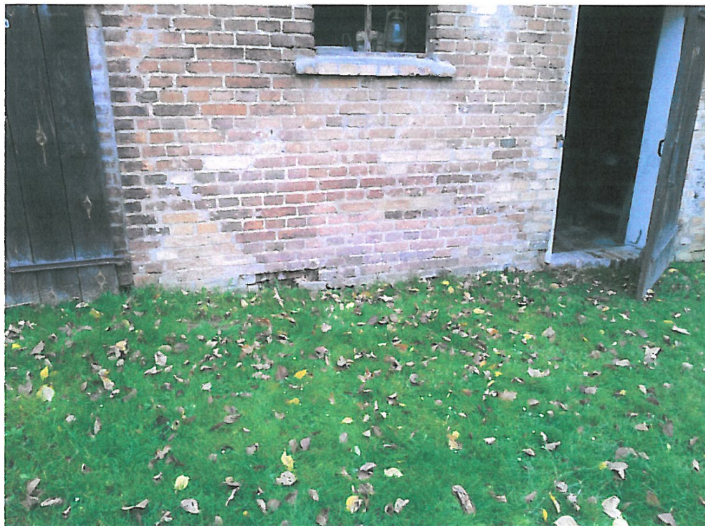
Widoczne ubytki w ścianach.
