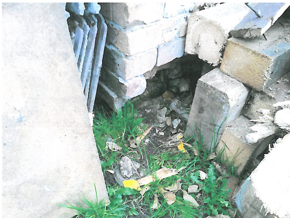
Widoczne ubytki w ścianach
